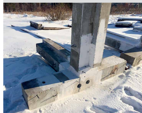
Система РКД. Узлы «колонна-ригель» после испытаний. Отверстия в бетоне — выбуривание образцов для исследования внутренней структуры бетона.
